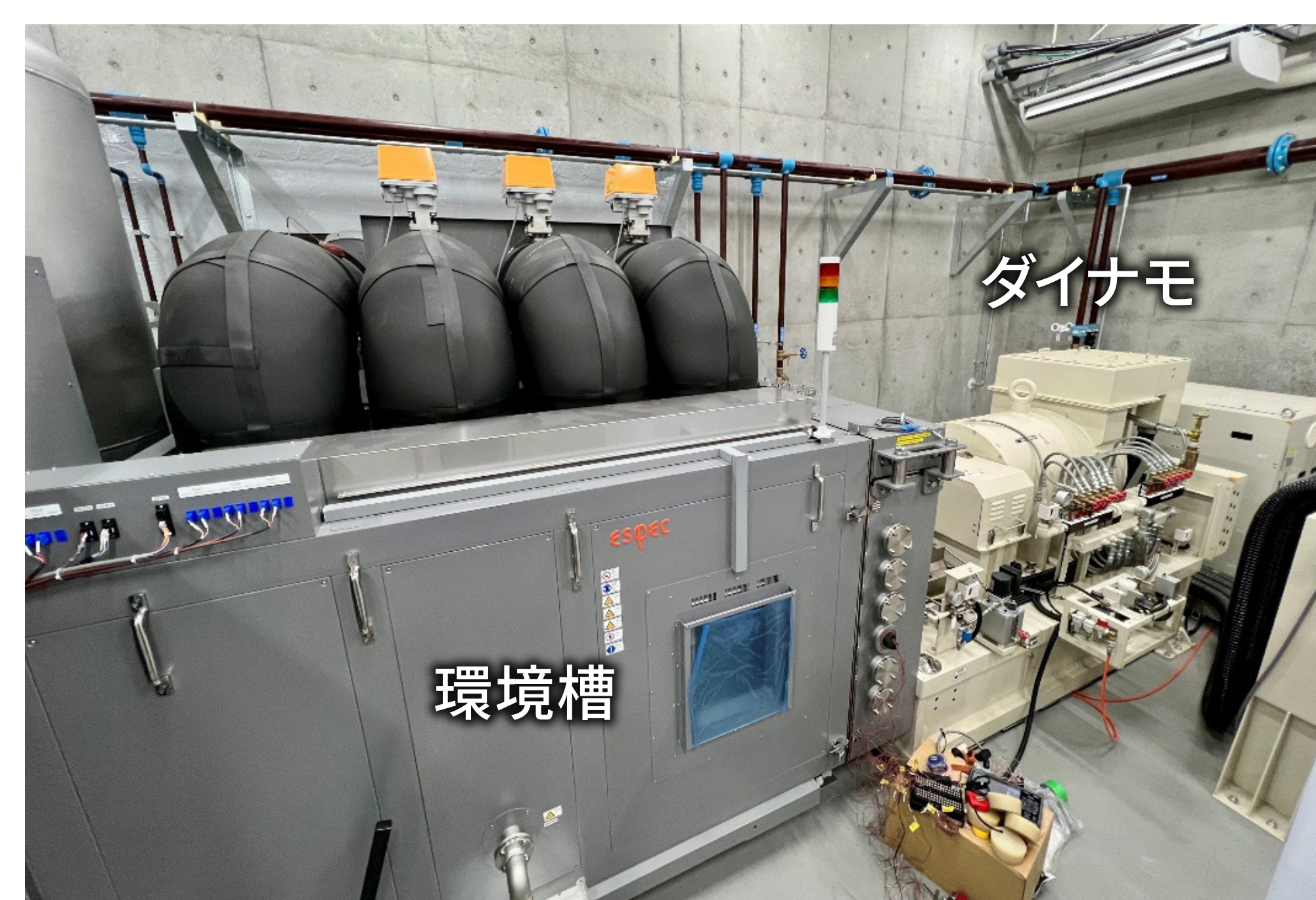
新規整備した環境試験設備 (福島ロボットテストフィールド)
